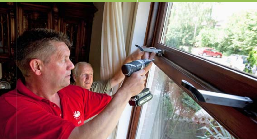
Bennie Evers brengt nieuwe, stevige raamboompjes aan, terwijl bewoner Bertus Medze de werkzaamheden belangstellend volgt.
